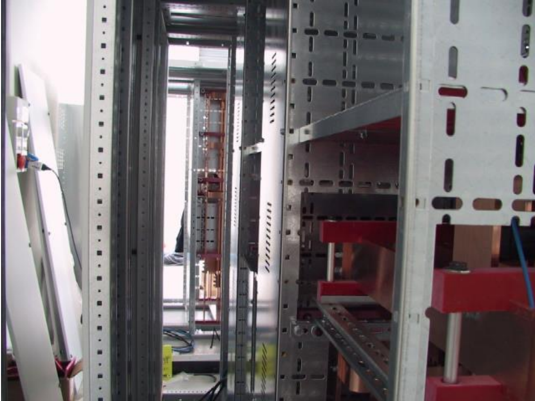
In fase di montaggio - Spazio posteriore per arrivo cavi in entrata - uscita
