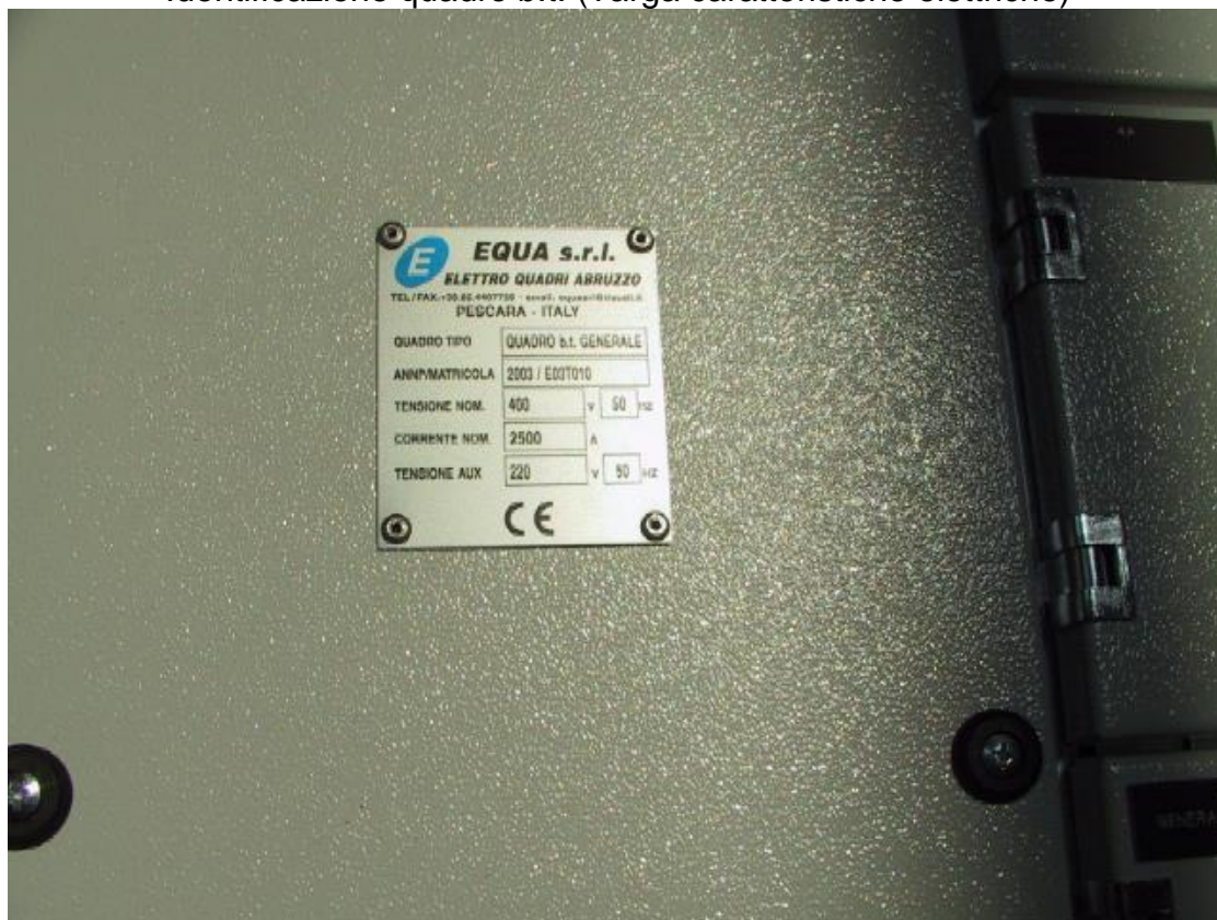
Identificazione quadro b.t. (Targa caratteristiche elettriche)
